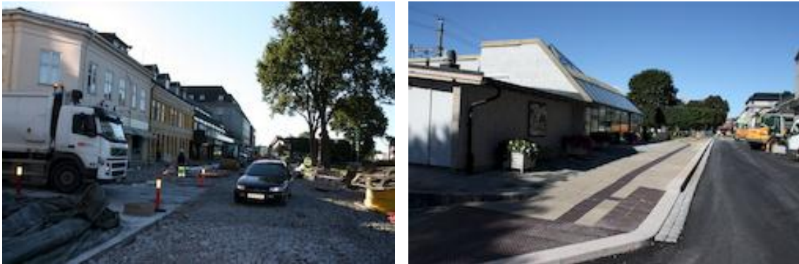
Bilde 24 Strandgata under opprusting og planlagt utforming ved ferdigstilling 1.juli 2013 (Hamar kommune 2012)
