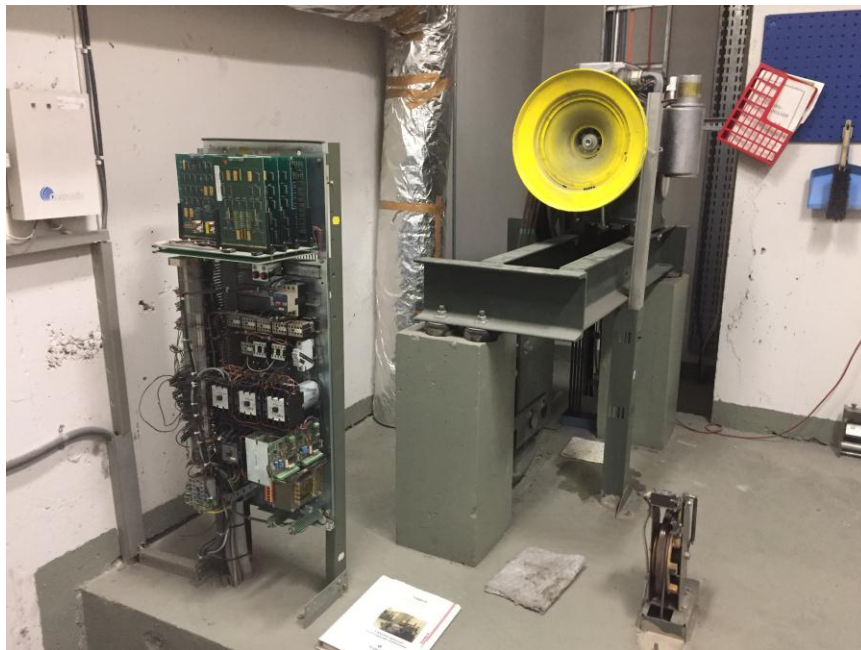
Figur 5 – Motor, drivverk og styreskap for heis 1989
