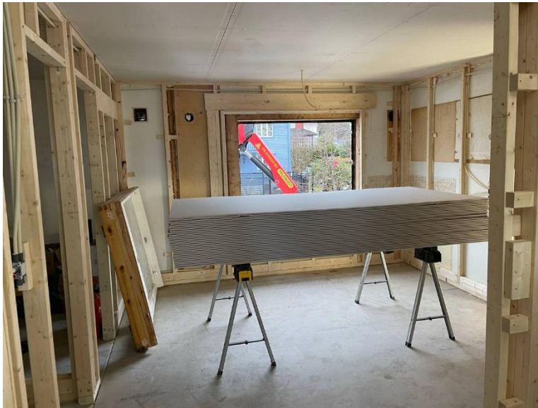
Figur 8: Varene på plass etter god hjelp fra leverandør. Krefter og tid spart. Bilde: Privat
