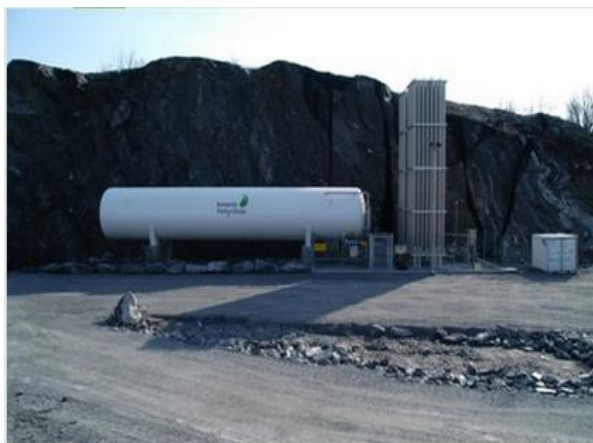
LNG Terminal in Bodø
