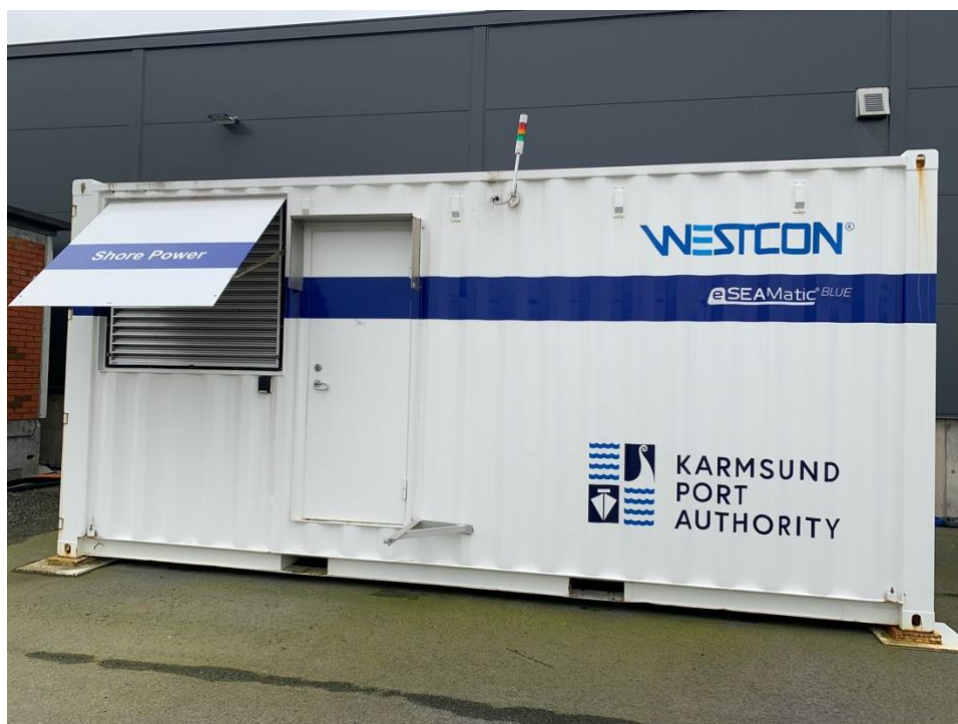
Figur 4: Bilde av landstrømanlegg på Garpaskjær Karmsund Havn (privat foto)
